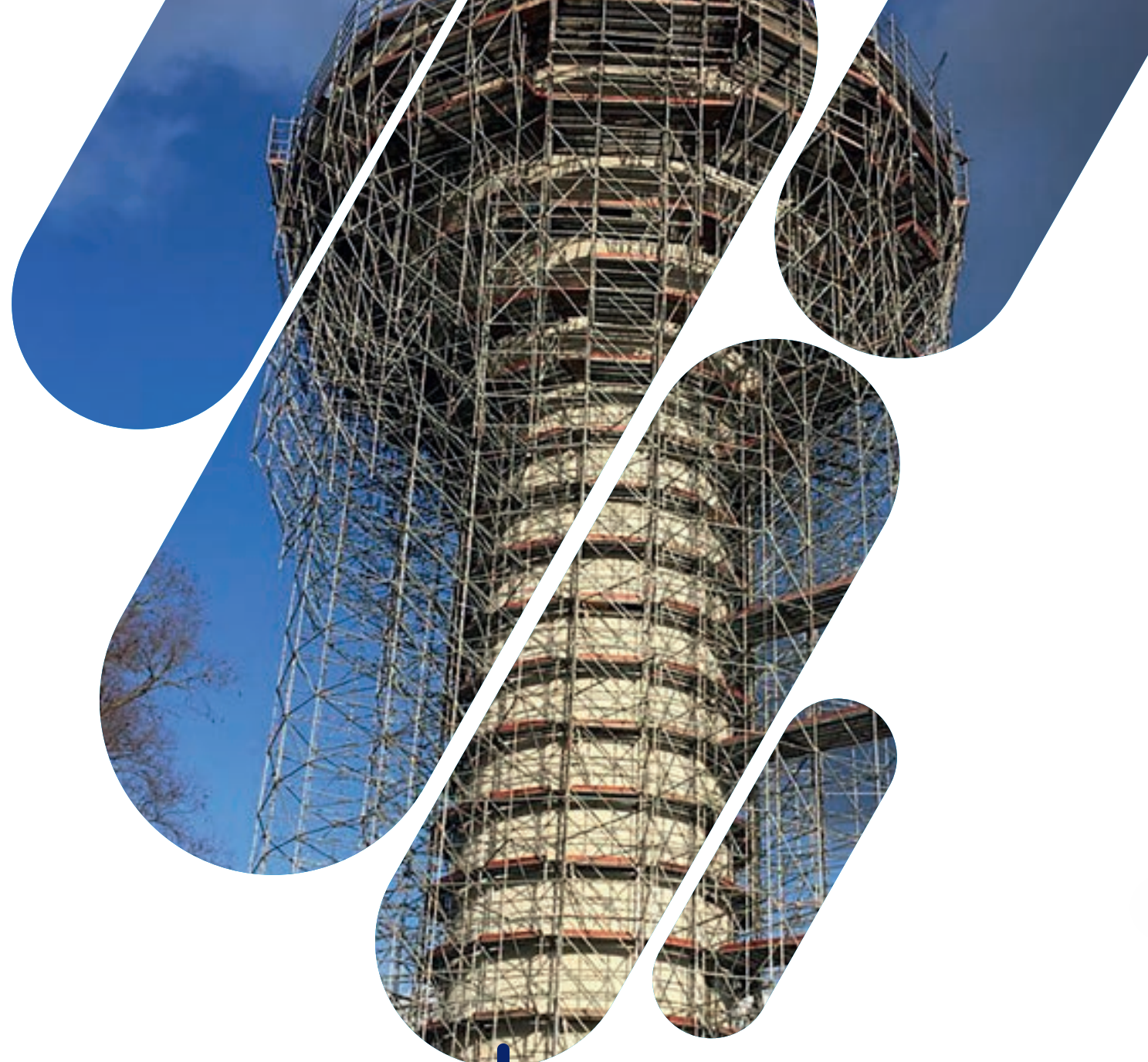
Moyen d'accès château d'eau Roissy en Brie
